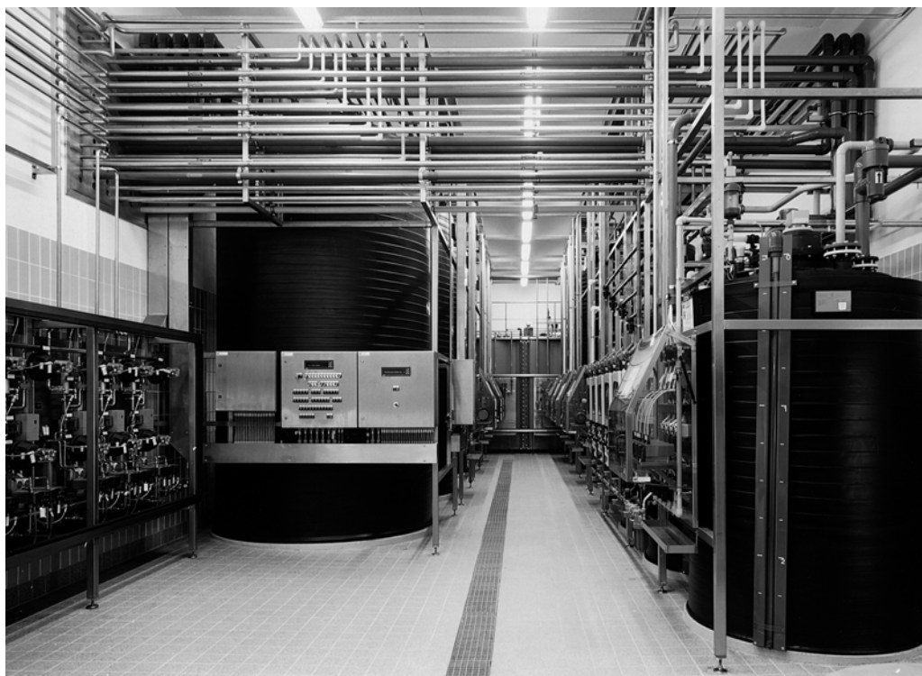
Figura 10.11 Sistemi di stoccaggio in sicurezza e centralizzazione della gestione dei sanificanti e dei lubrificanti. (Per gentile concessione di Ecolab S.r.l. - Food & Beverage, Italia)
