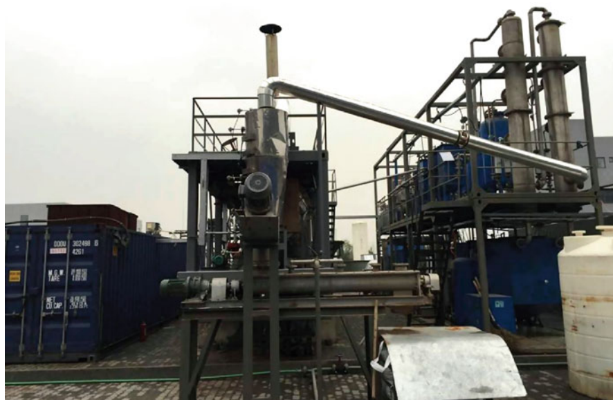
Fig. 1 Thermal desorption unit
