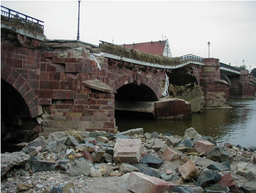
Fig. 6.14 Pöppelmann-Bridge in Grimma after the 2002 Flood ( Picture T. Bösche )
