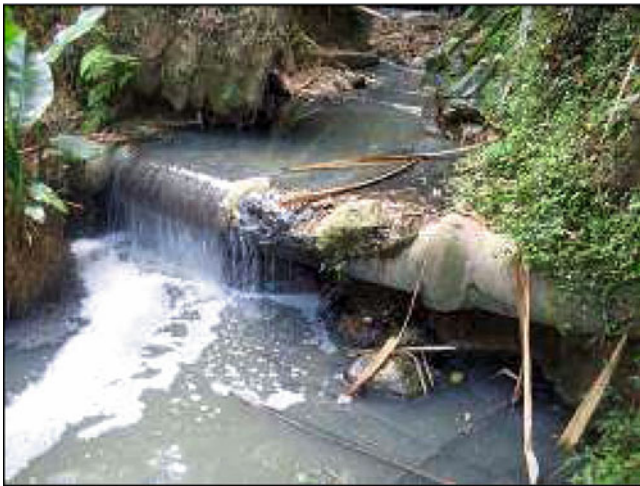
Fig. 7 Scour in La Heliadora creek
