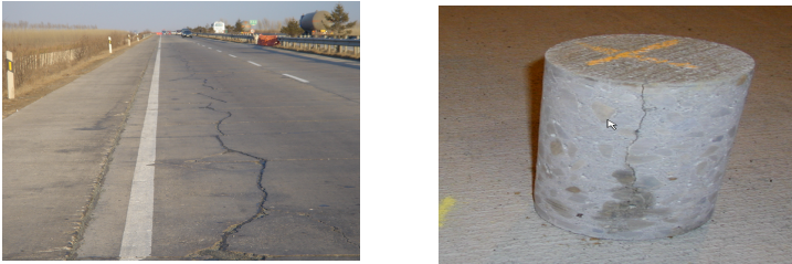
a) Longitudinal cracks
