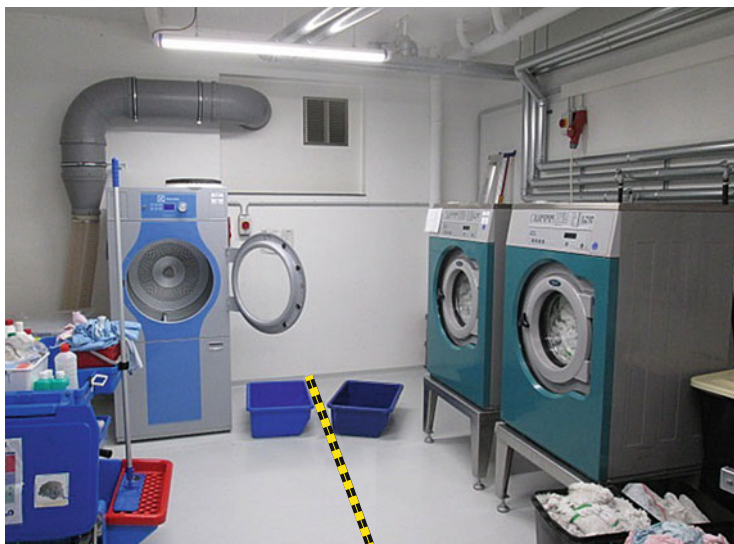
■ Abb. 5.24 Klare optische Trennung »unreiner« und »reiner« Bereich mit optischem Trennungstreifen auf dem Fußboden
