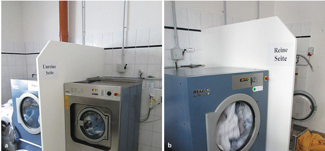
■ Abb. 5.23a, b Waschraum mit Trennwand bei Raumknappheit und Beschriftung »reine Seite«/»unreine Seite«
