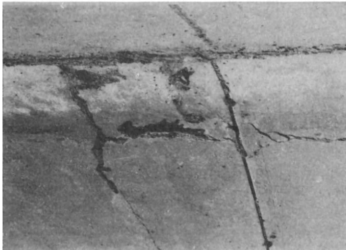
Fig. 5.5. Crack in the concrete apron.
