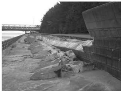
(d) River embankment without improvement.
