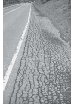
Edge fatigue crack
