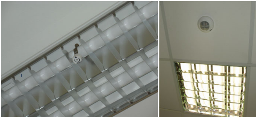
Fig. 3 ALS connected directly to the ballast for individual luminaires ( left ) and ALS connected to lighting control system for a group of luminaires ( right )
