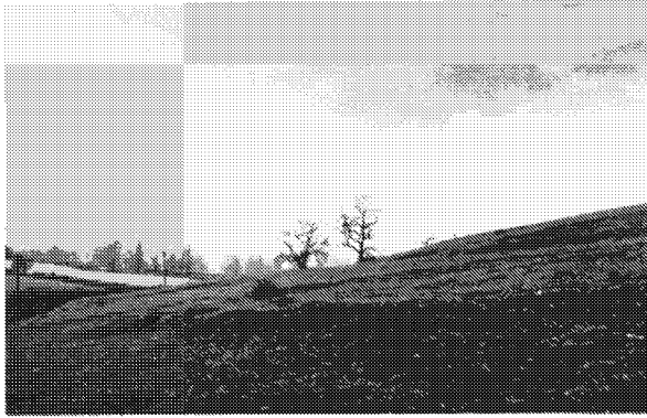
Fig. 3. Childerditch No. 1. 10½ degree slope, active slip Talus à 10½ degrés, glissement en course
