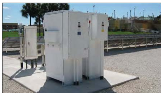
Photo 10 - Solectria PVI 100 KW Rectifier
