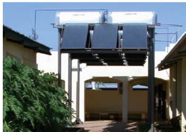
{ FIG. 2.2 } Utilização de painéis solares térmicos para aquecimento de águas.
