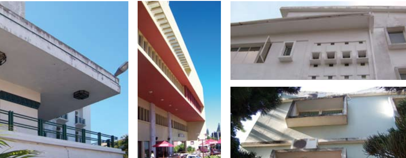
{ FIG. 3.22 } Sombreamento fixo de fachada por projecções horizontais (esquerda); sombreamento fixo de janelas (direita).
