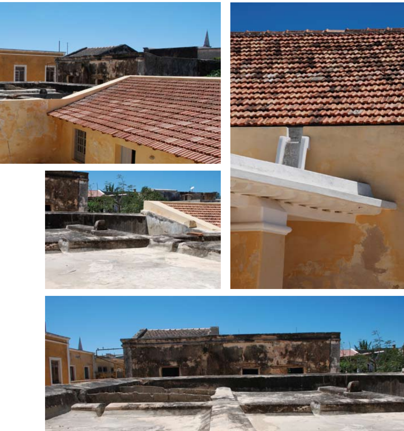
{ FIG. 4.8 } Sistema de captação e armazenamento de água da chuva na Fortaleza da Ilha de Moçambique. A água é captada na cobertura dos edifícios, sendo conduzida para uma cisterna subterrânea, onde é armazenada.
