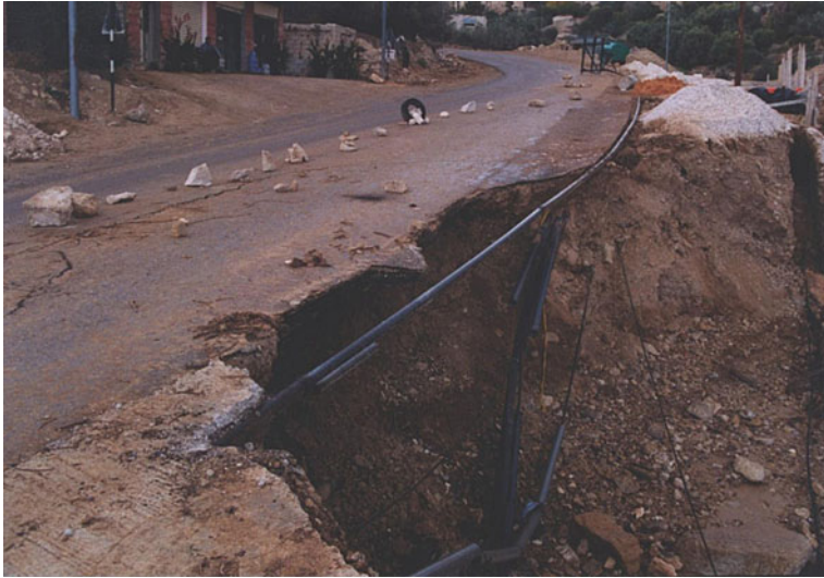
Fig. 5.6 Flash flood damage in Wadi Musa
