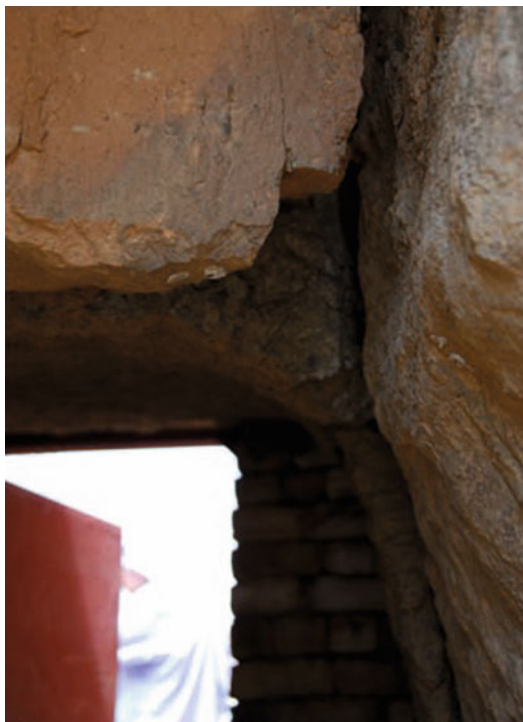
Sensor n. 5 (entrance top level corridor)
